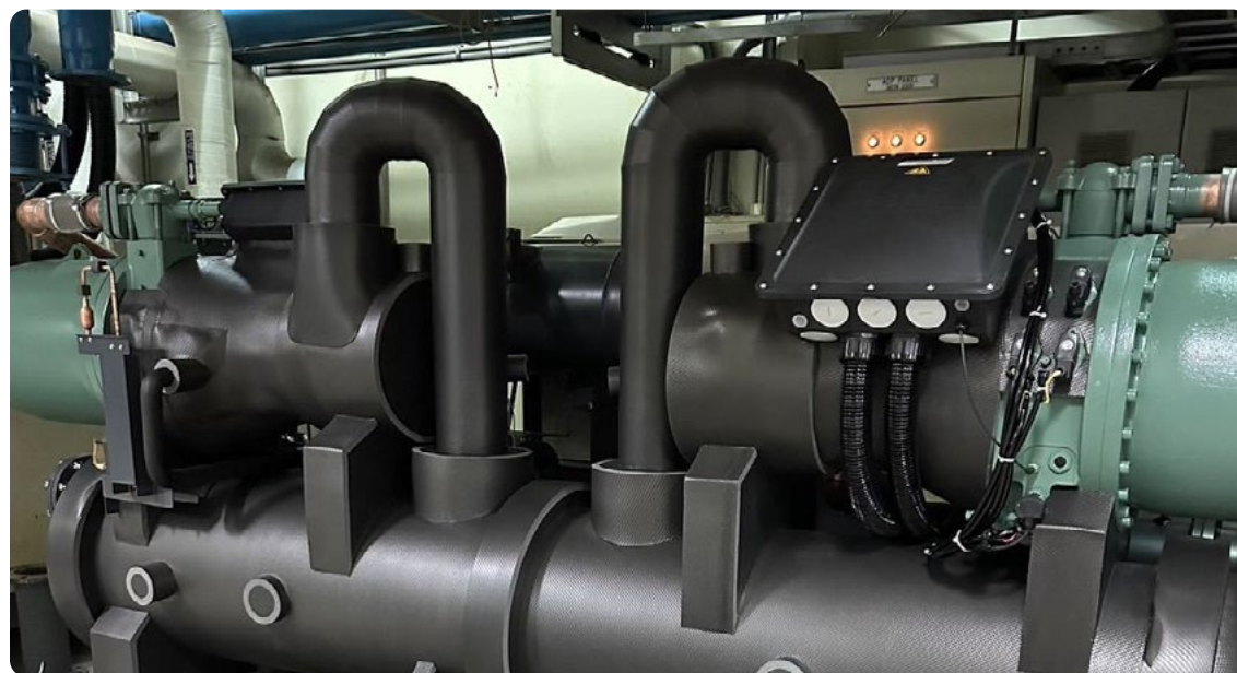
台積公司補助供應商升級冰水主機
